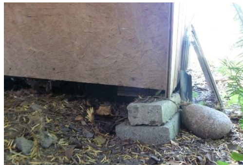
Abb. Hohlraum unter einem Gerätehaus
